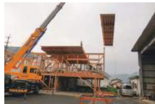
在来工法による壁の上にLVLの床パネルと屋根パネルを施工
