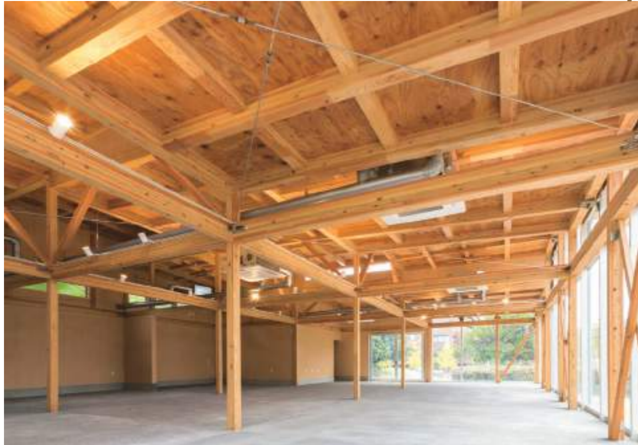
現代の技術を駆使して完成した伝統的な日本建築。木とガラスの組み合わせがスタイリッシュ感をプラス
